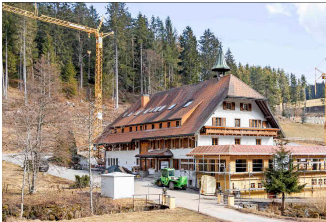
Am bestehenden Gebäude des Hotels Schlüchtmühle wird die bisher freiliegende Terrasse umbaut. Der Gemeinderat stimmte der Befreiung von den Bebauungsvorschriften zu. FOTOS: WILFRIED DIECKMANN
